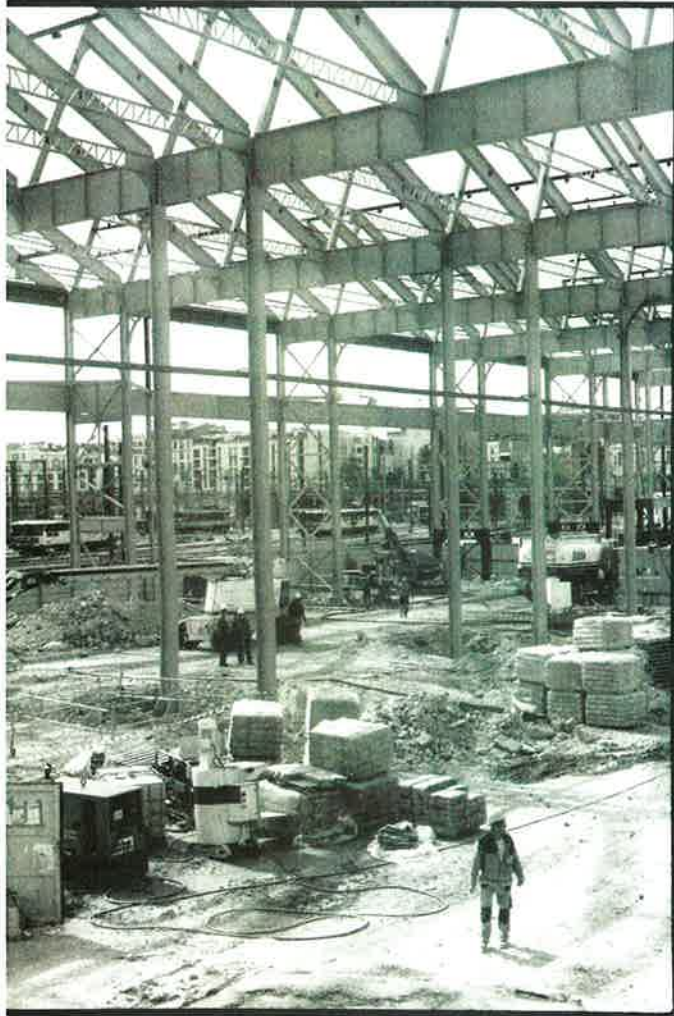
Les travaux à la mi-mai dans la grande halle, complètement déshabillée, dont ne reste que les structures métalliques. (Dossier pages 2, 3 et 4.)
